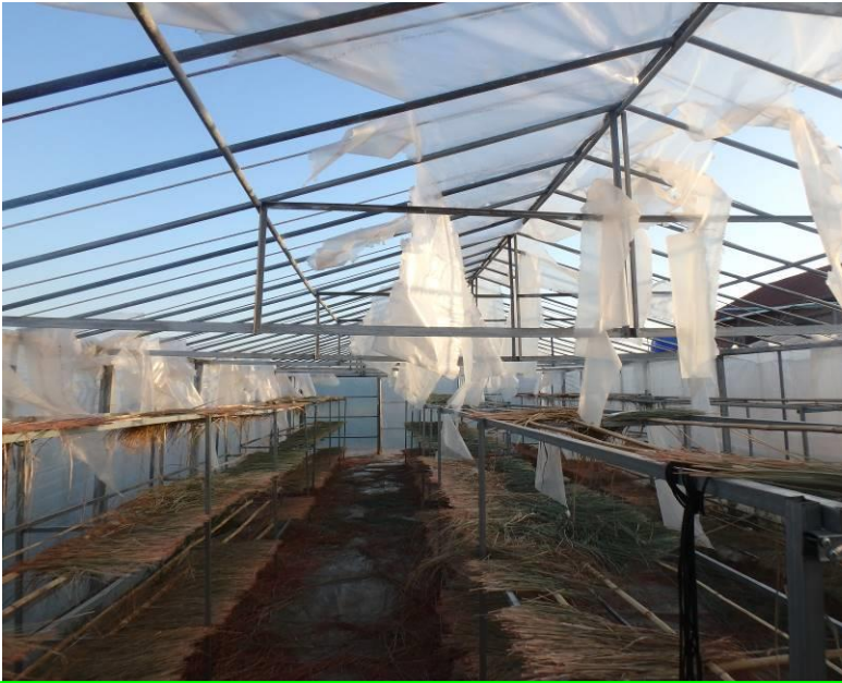
屋根のビニールが大破したビニールハウス
