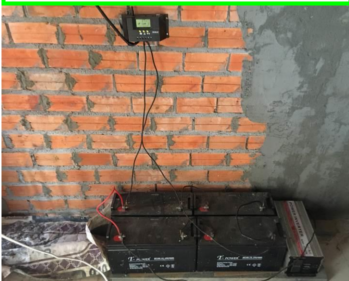
太陽光発電蓄電、変圧設備
