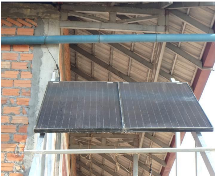
南側に設置されたソーラーパネル
